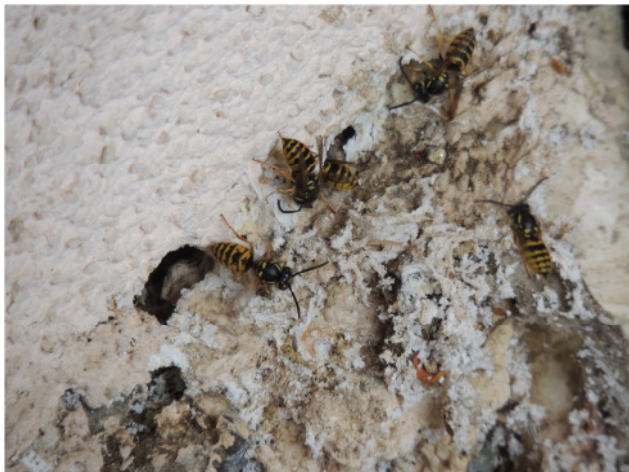
Wespen in Fassade
